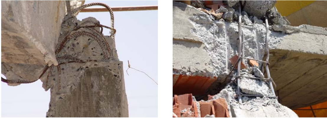
Figure 10.23. Effondrement dû à l'absence d'armature transversale au nœud.
