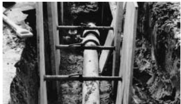
Les conduites enterrées sont difficilement accessibles
