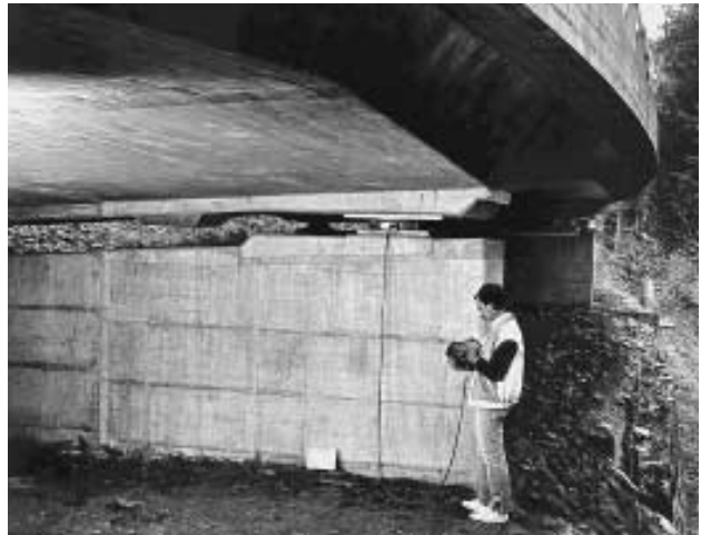
Appuis du pont de Caselertobel dans le canton des Grisons, équipés pour la mesure des forces. Le pont traverse une zone de glissement, ce qui justifie une surveillance intensive.
