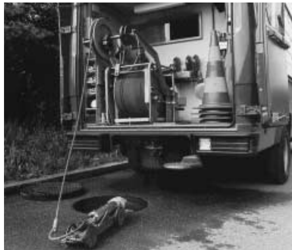
Véhicule pour caméra de télévision pour canalisations en cours d'auscultation
