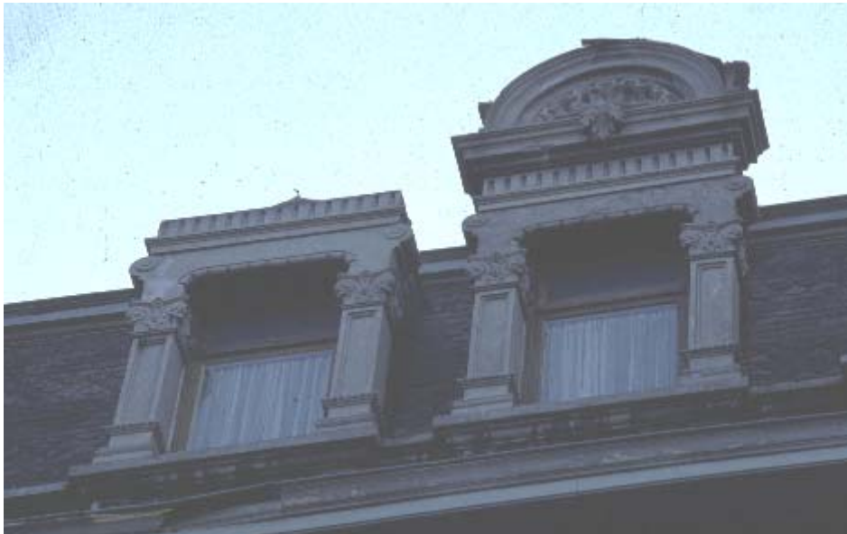
Figure 5.31a). Le fronton de gauche a basculé...voir l'effet à la figure suivante... (situation inchangée à ce jour...)
