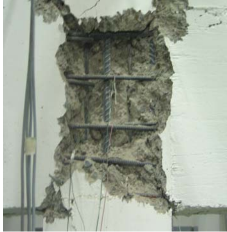
Figure 10.21. Etat Limite Ultime d'un nœud correctement armé dans une situation « poutre forte-poteau faible ».
