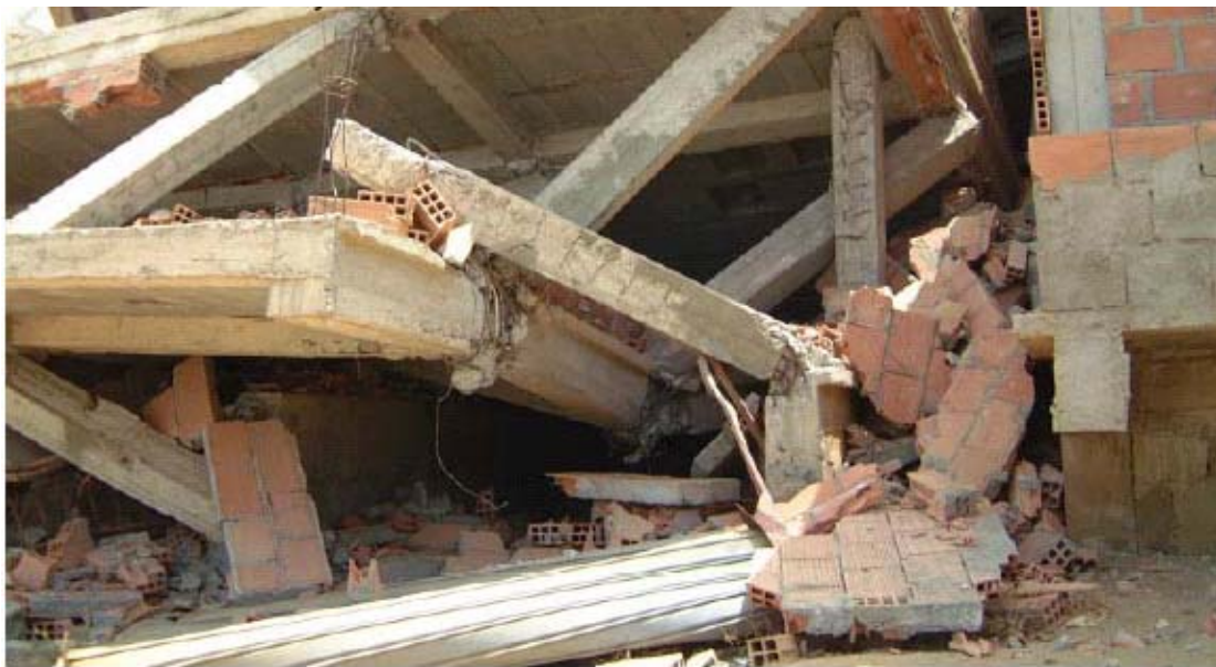
Figure 5.36. Ossature en portique de béton armé en construction et effondrée (Boumerdes, 2003).
