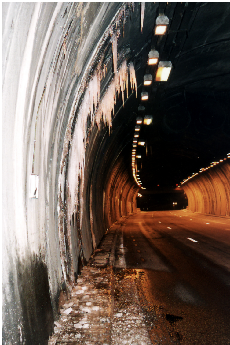
FIG. 1.17 – Stalactites de glace dans le tunnel des Monts en 2002, montrant la présence de défauts dans l'étanchéité du tunnel (Doc. Cetu). Ce tunnel a fait l'objet d'une rénovation lourde en 2005.
