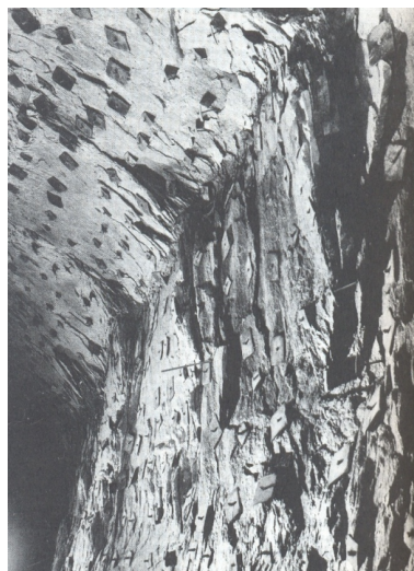
FIG. 1.14 – Ecaillage des parois du tunnel du Mont-Blanc lors de sa construction. Remarquer la forte densité de boulonnage.
