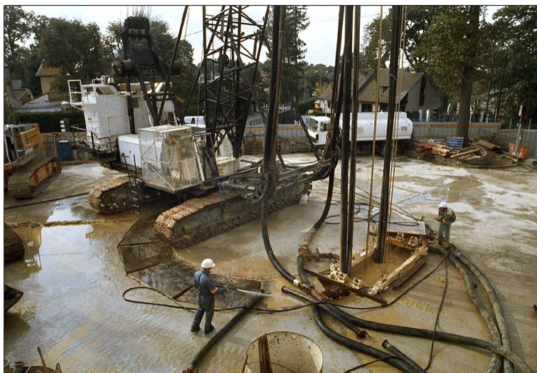
FIG. 1.15 – Creusement de parois moulées avant l'excavation du puits de la Place Berthet sur le chantier de l'A86 (Doc. Socatop 2001)
