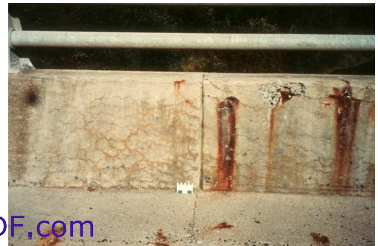
Taches de rouille Rust Staining
