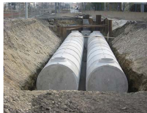
Bassin enterré (Source Bonna-Sabla)
