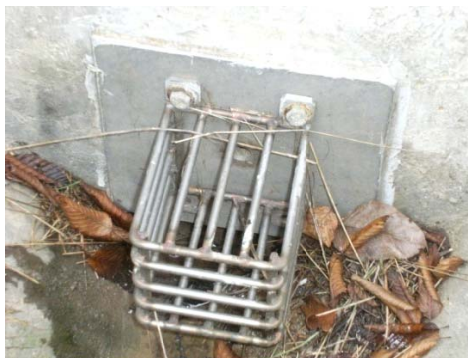
Figure 6: Cage de protection d'un ajutage (source: OIEau)
