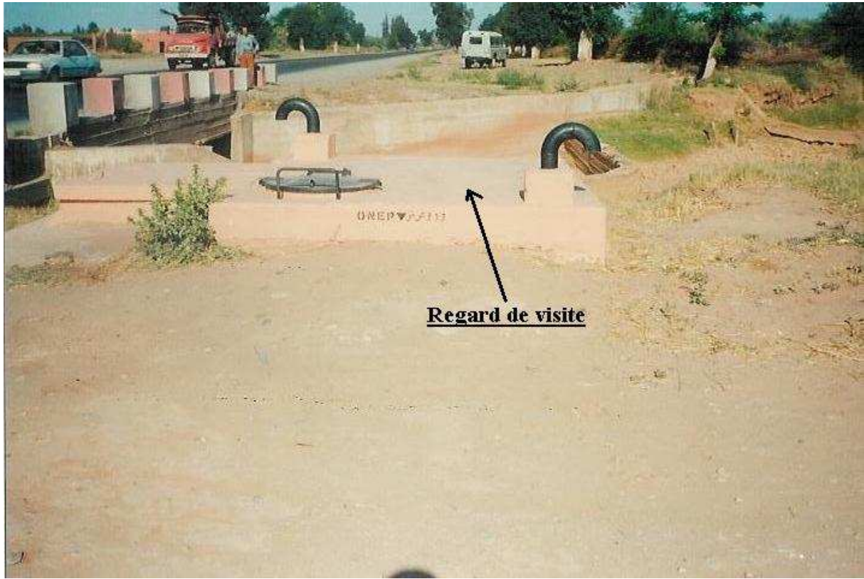
Conduite ONEP longeant la route nationale Marrakech-Essaouira collectant l'eau de 13 forages dans le champs captant de Nfis pour l'AEP DE Marrakech
