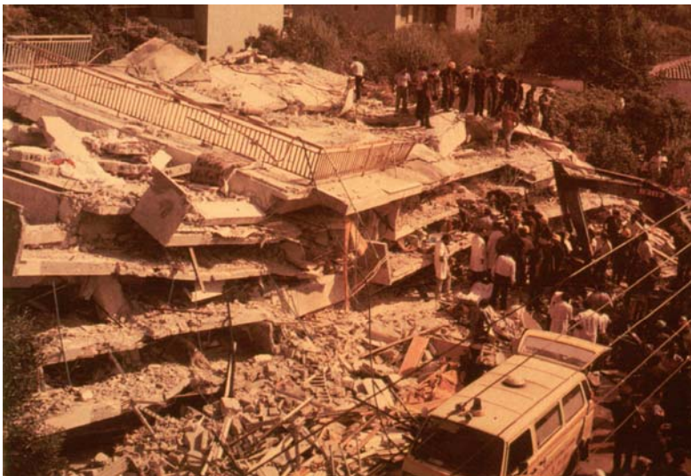
Séisme de Kalamata – Document x - Ce type de ruine par empilement des dalles est typique d'une absence de contreventement vertical.
