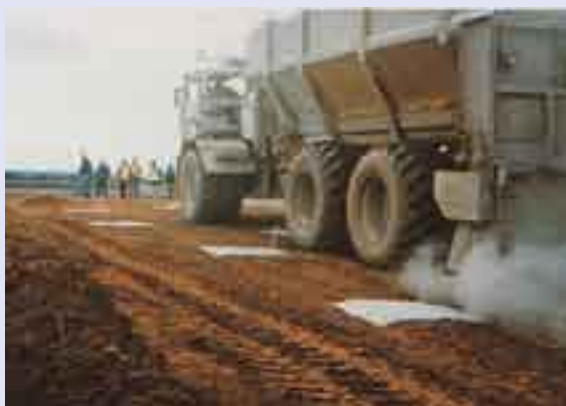
Positionnement aléatoire des bâches sur chantier.
