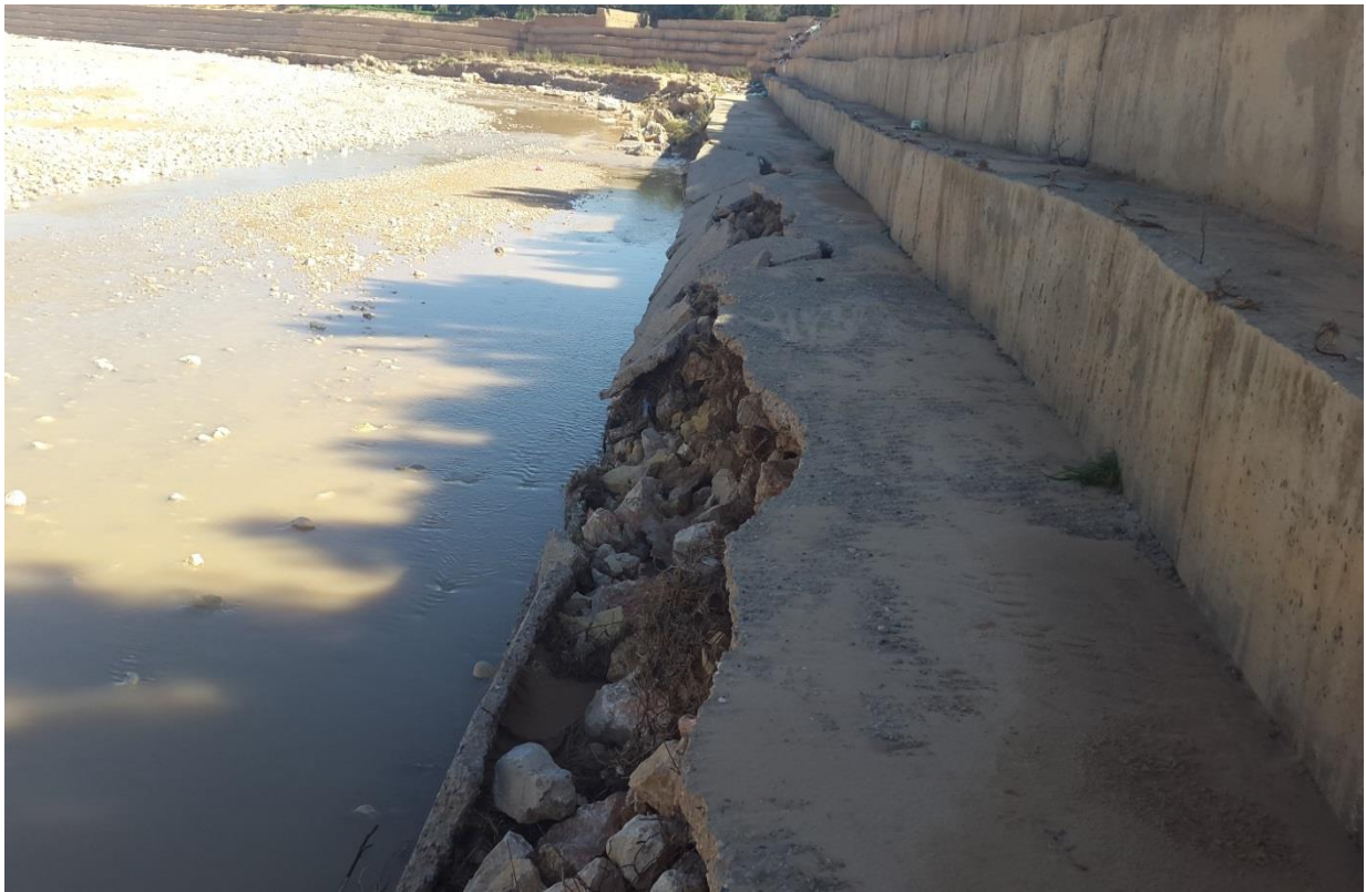
Figure 54: Dégâts de crues antérieures- problème d'affouillement
