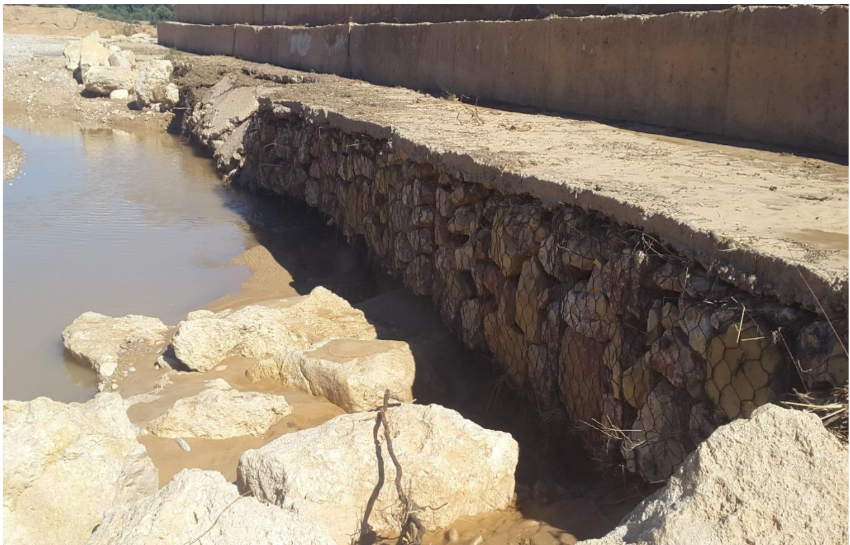
Figure 55: Dégâts de crues antérieures- charriages grossiers
