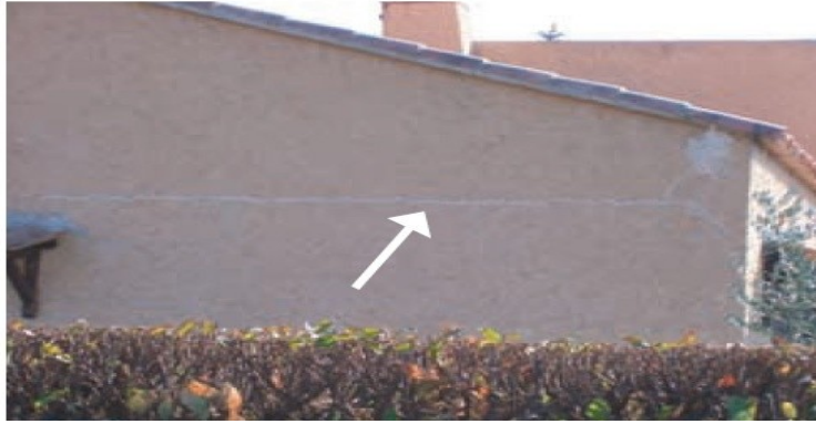
Figure IV.10: Fissuration traduisant un décollement de la structure par absence de liaisonnement entre niveau bas et combles.
