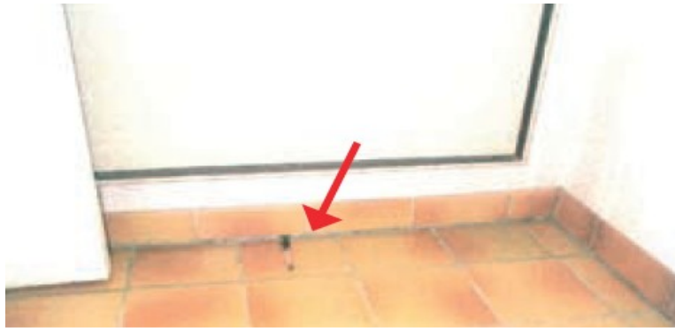
Figure IV.11: Affaissement du plancher mis en évidence par le décollement entre plinthes et dallage
