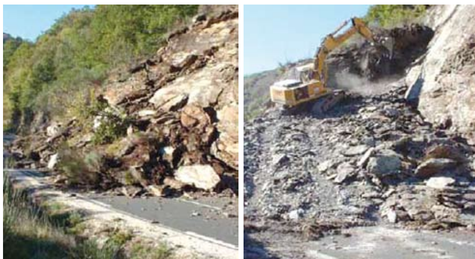
▲ Figure 62 : purge d'un éboulement sur voie de circulation [Génois, CETE]
