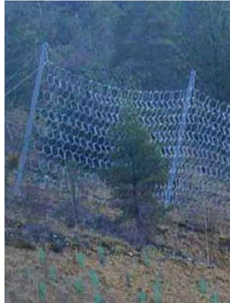
▲ Figure 40 : filet de protection déformable [Genois, CETE]
