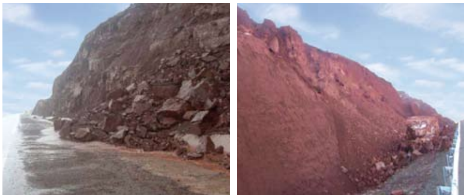
▲ Figure 3 : Chute de blocs sur l'autoroute Marrakech – Agadir 2010 au Maroc [Photo ADM]
