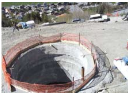
▲ Figure 78 : Puits drainant en réalisation à l'endroit de l'éboulement du Belvédère de Gimillian, vallée d'Aoste [RiskYdrogeo]
