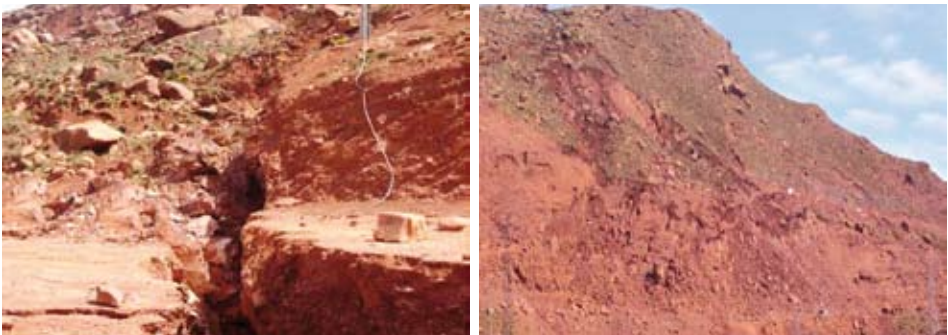
▲ Figure 87 : Déblai D15 - Glissement sud (mars 2010) [Photos ADM]
