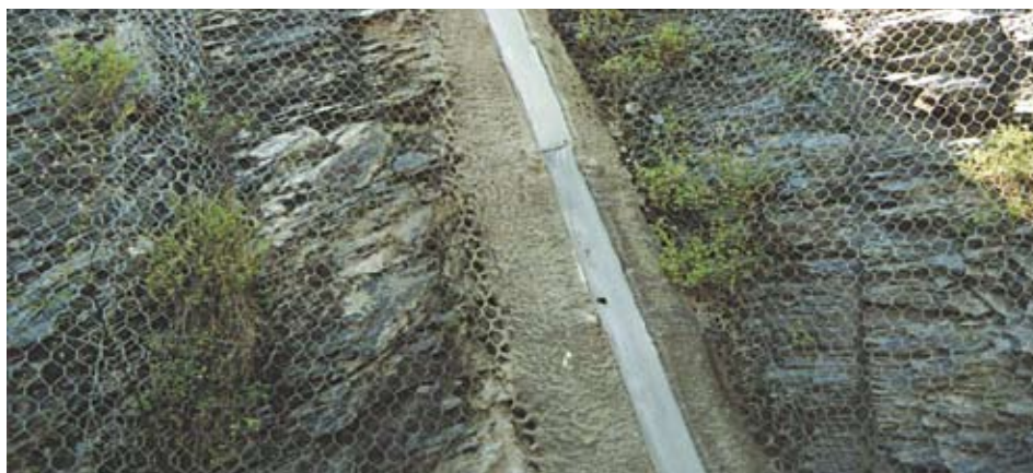
▲ Figure 73 : Evacuation des eaux superficielles le long d'une paroi rocheuse (RN 205 à Servoz, Haute-Savoie)
