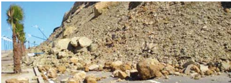
▲ Figure 4 : glissement de la corniche à El Hoceima au Maroc [Photo ADM]
