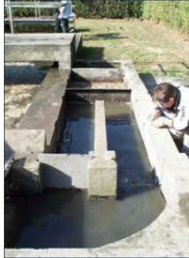
Figure 26 : Dessableurs couloirs ou canaux (petites stations)
