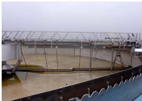
Figure 35 : Pont raclé-suceur sur un clarificateur secondaire
