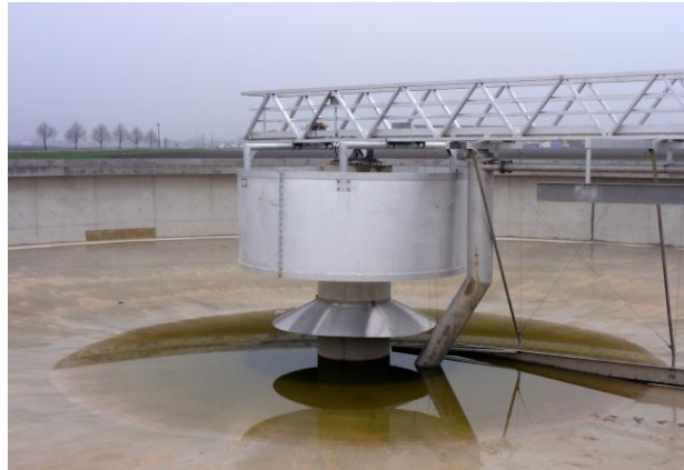
Figure 34 : Jupe de répartition d'un clarificateur secondaire
