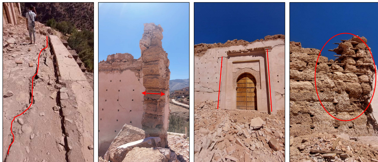
Fig. 54 : Exemples de dégâts relevés sur place après le Séisme
