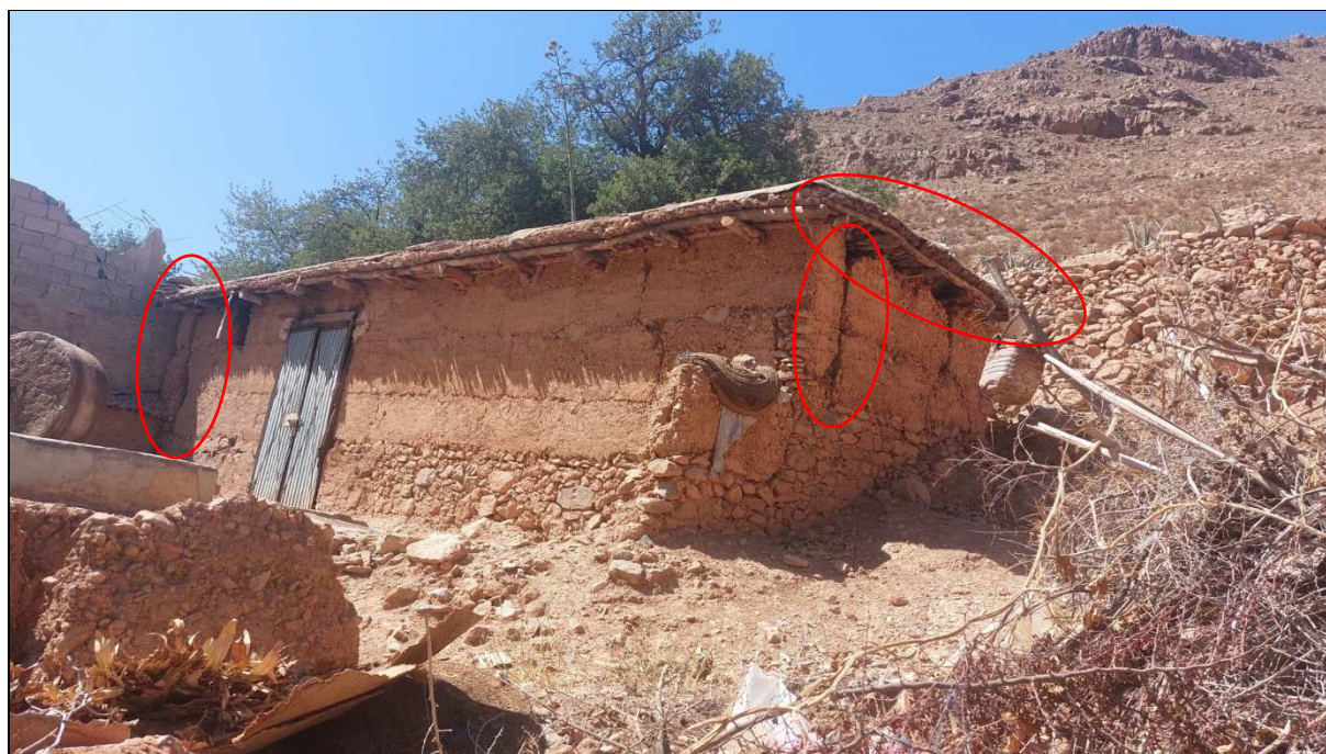
Photo IGH 03 02 : Exemple de bâtiment non effondré sur douar Ighfis (Tizi n'Tast, Taroudant)
