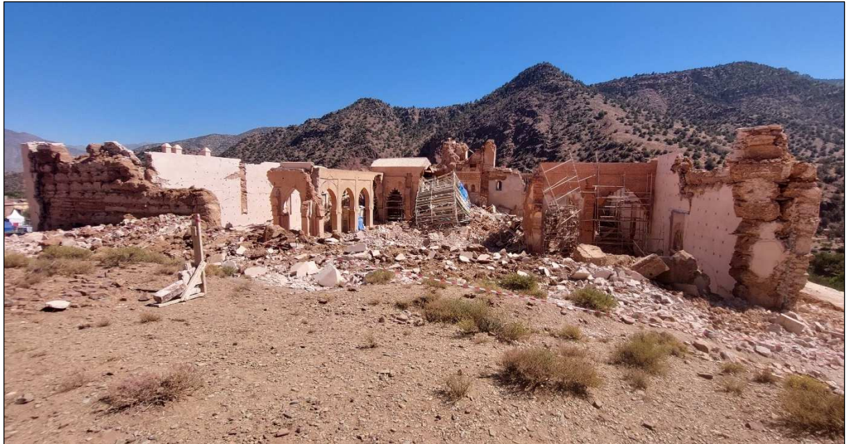
5 6 Fig. 56 : Vue du nord de l'édifice de Tinmel après le Séisme
