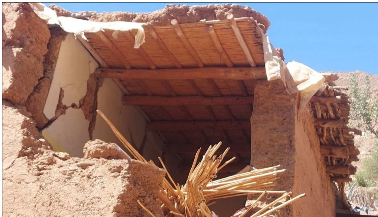
Fig. 28 : Effondrement partiel d'une toiture traditionnelle montrant ainsi les détails de sa conception
