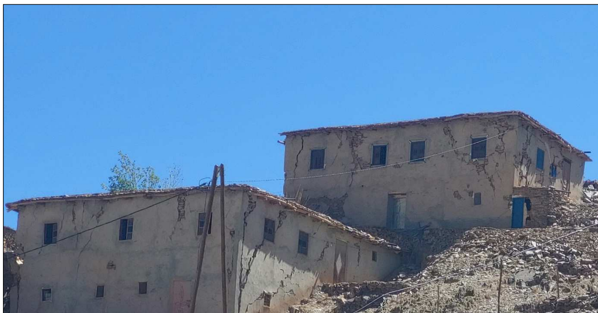
Fig. 29 : Fissurations dues à l'action sismique très visibles grâce à l'enduit de finition
