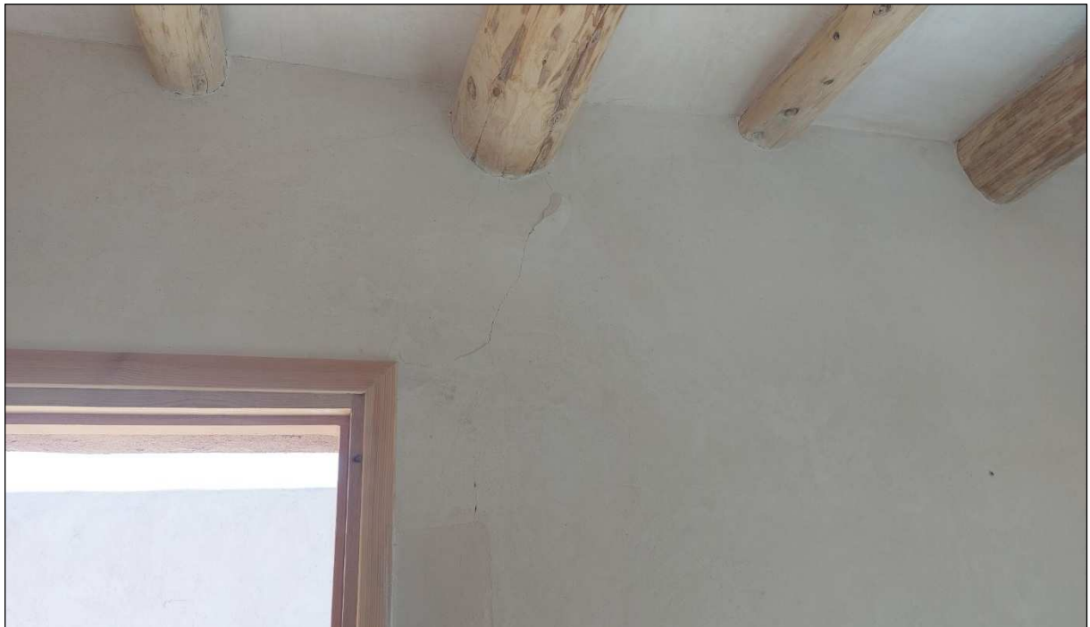
Fig. 49 : Dégâts très légers et insignifiants causés par l'action sismique
