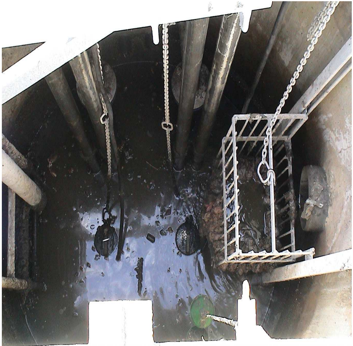
Exemple de photo d'un panier dégrilleur
