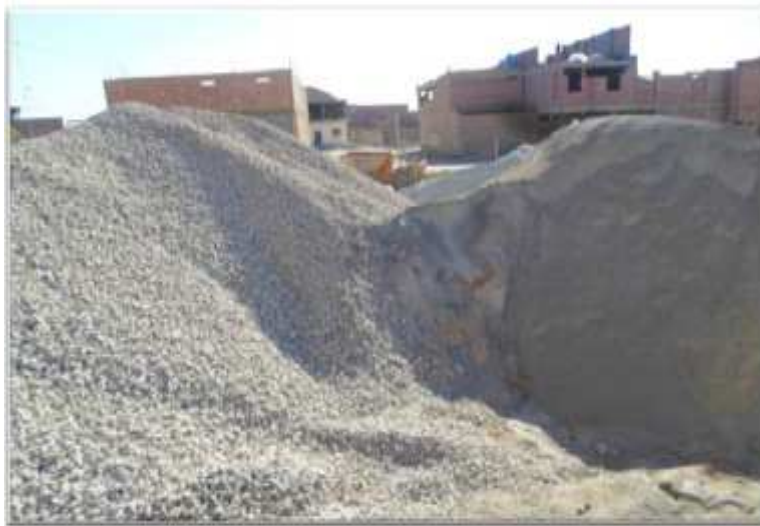
Figure 24 : stockage du gravier et du sable
