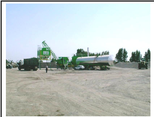
Vue d'une centrale d'enrobage
