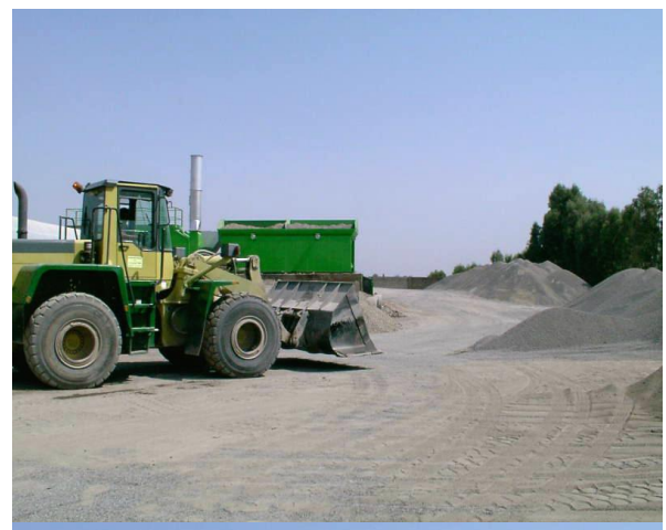
Vue des stocks et des trémies de granulats
