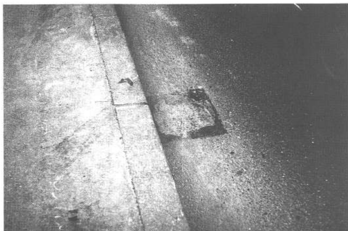
Figure 13 Colmatage d'un avaloir à tuyau de trop petit diamètre.
