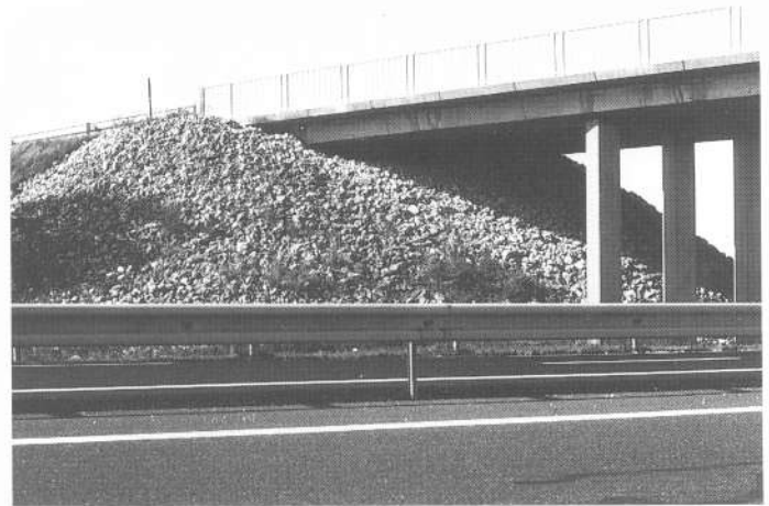
figure 25 Perré en cailloutis. Cette solution peut s'avérer satisfaisante, cependant il est déconseillé de traiter ainsi le quart de cône où la végétation aurait repris facilement atténuant l'impact visuel du perré. Ce perré n'empêche pas le développement d'une végétation difficile à maîtriser dans cette zone.
