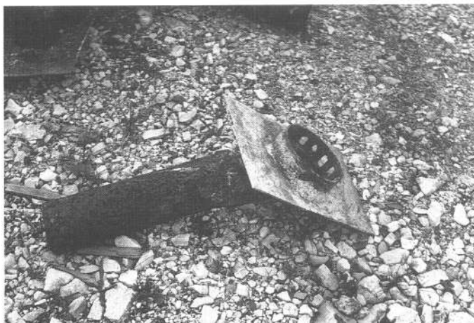
Figure 5 La protection contre la corrosion par une peinture bitumineuse s'est avérée insuffisante face aux sels de déverglaçage. Au bout de 3 ans le tube en acier présentait cet état de corrosion.
