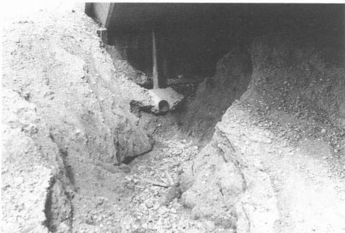
Figure 4 a) érosion d'un remblai sous une travée de rive par défaut de continuité du tuyau.
