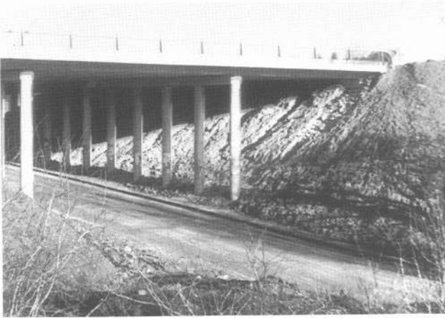
figure 1 En l'absence de perré le remblai subit un ravinement, surtout si l'on a pas prévu des descentes comme sur la figure 2 ci-contre.
