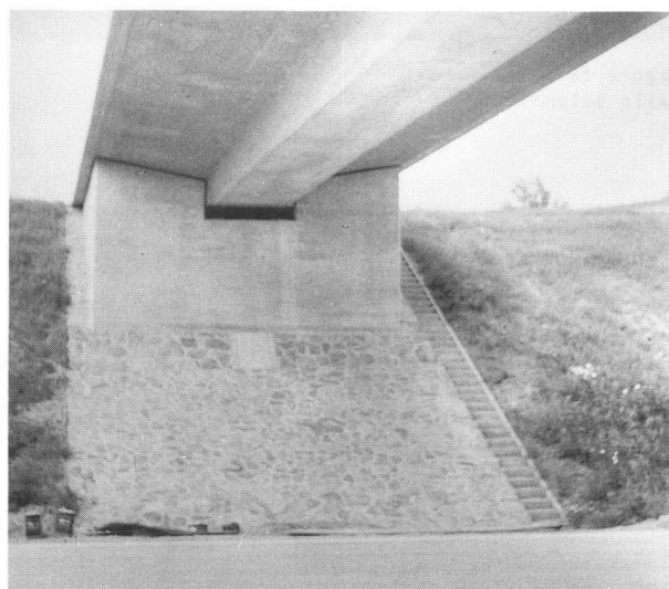
figure 13 Opus incertum. Noter, en bordure du perré, l'escalier d'accès à la culée
