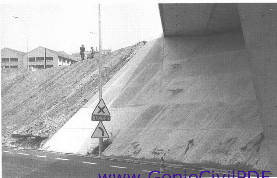
figure 5 Il n'est pas utile de projeter des surfaces aussi importantes avec un perré (d'autant que la solution dalle en béton n'est pas très heureuse). La végétation aurait permis la stabilisation de la partie du remblai non située sous l'ouvrage.
